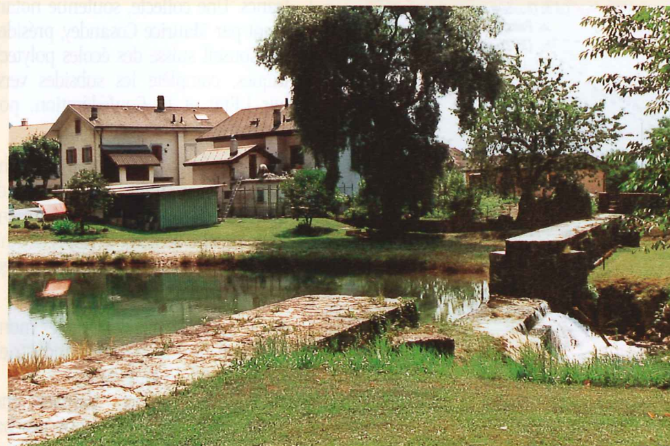
Bassin de réception à Roche comblé aux trois quarts. La longueur des murs indique les dimensions d'origine du bassin
