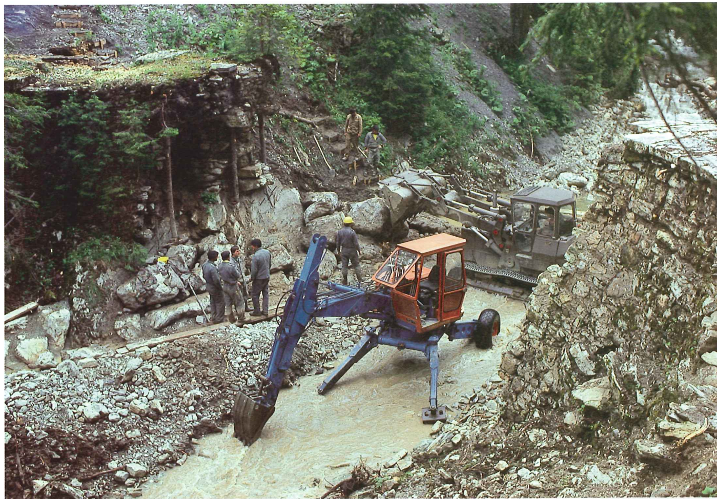
Approfondissement du lit du torrent en vue de la pose des digues de protection au droit des deux culées
